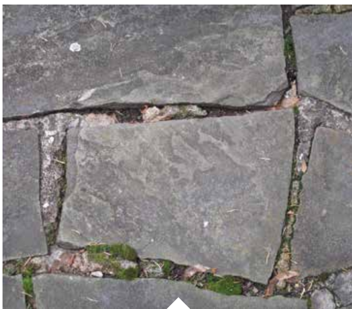
Spoiny z zaprawy murarskiej mogą pękać i gnić
